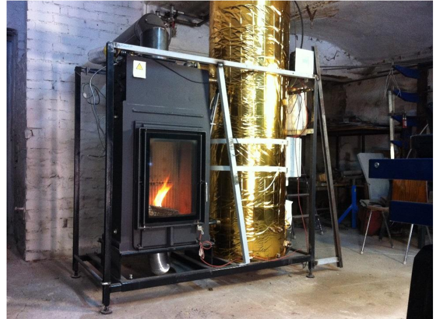
Kamin-Heizzentrale als „Werkstattheizung im Industriedesign“
